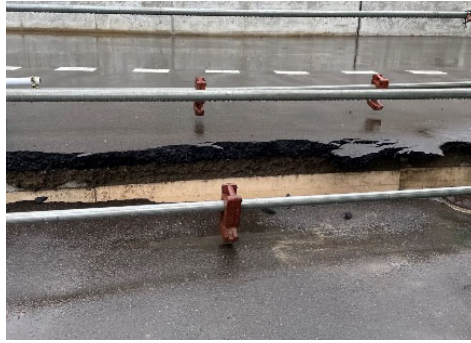
写真-5 EPSの浮き上がりによる道路面変状
