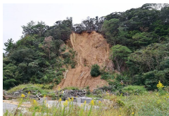
写真-2 斜面崩壊
