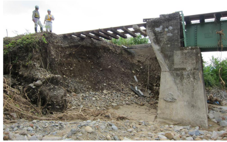
(a)被災状況
