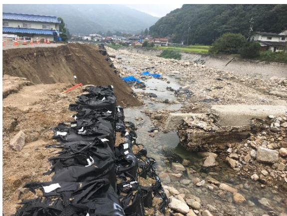
堤防仮復旧箇所の被災状況
