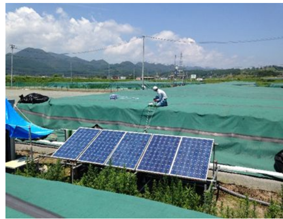
写真-7 電源(太陽光発電)
