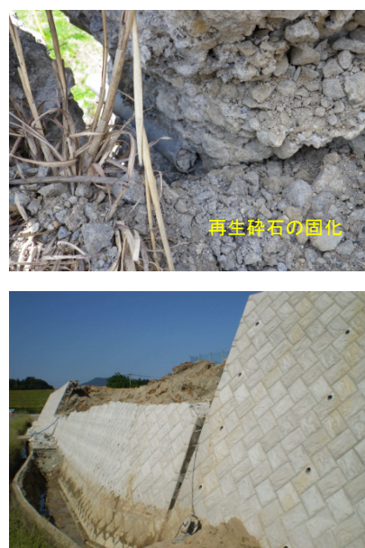
図-2 再生砕石不具合事例
