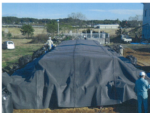
図-12 ガス透過性防水シートが適用された 除染廃棄物仮置場の施工状況 (1)
