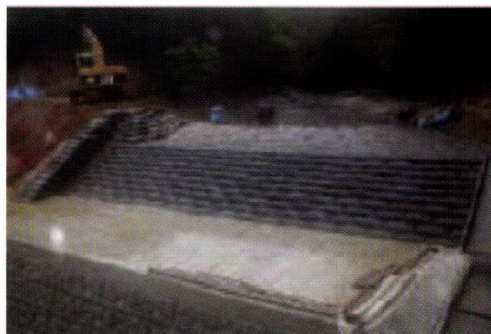
テール土嚢を用いた平田池の堤体改修 (土嚢設置完了状況)
