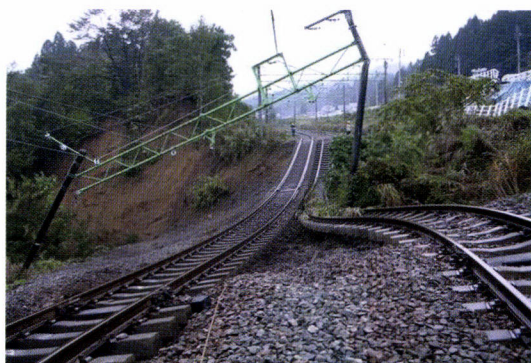
被災状況 (221k100m 付近)
