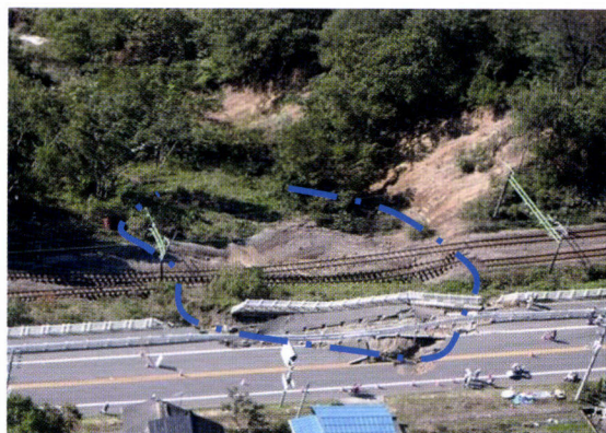
被災状況 (221k100m 付近)
