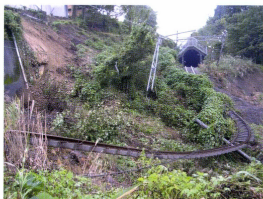
被災状況 (220k305m 付近)
