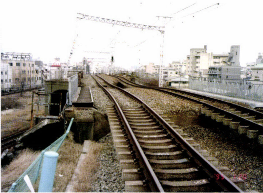
橋台部の被災状況 (兵庫県南部地震、1995. 1)
