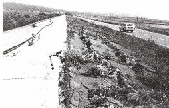
写真 日本海中部地震時による八郎潟堤防の亀裂
