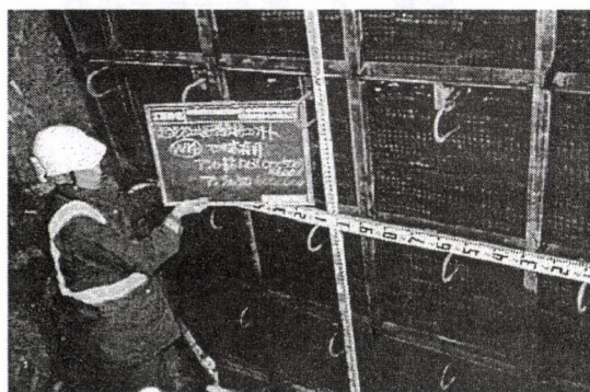
写真-4 アンカー筋と溝型鋼
