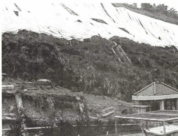
図-14 暨南国際大学の崩壊した補強盛土とのり枠アンカー工
