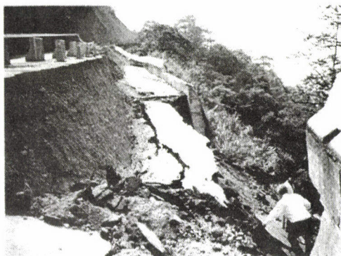
図-2 149線乙6km山岳道路擁壁の被害状況
