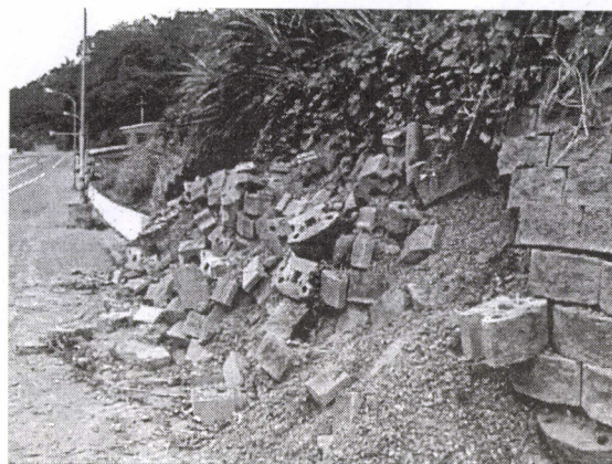
図-7 補強土擁壁Aの崩壊部の状況 (補強材の敷設間隔 80cm)
