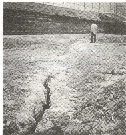
写真-11 擁壁前方の亀裂
