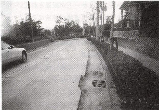
写真-6 現場周辺の液状化の状況
